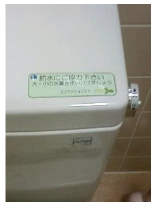
節水表示 トイレタンク（大・小の使い分け）
